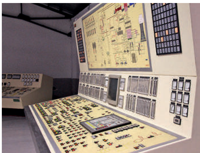
Simulador de la sala de control de la Central Térmica de Andorra instalado en el museo por miembros de la asociación.
