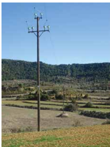
Línea con postes de madera en Alloza.
