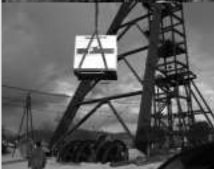
Traslado de la caseta del maquinista hacia la sala de máquinas. Al fondo, el castillete del pozo San Juan.
