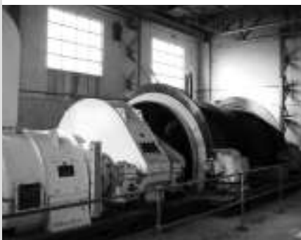
Conjunto de la máquina instalada en la sala de máquinas Plano n.º 2 de mina La Oportuna.
