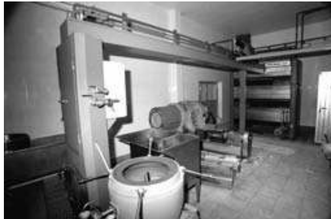
Instalaciones de la nueva almazara.
