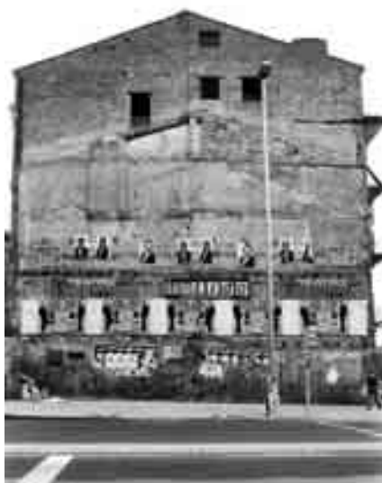
Medianera de la plaza de San Miguel antes de la intervención. (Foto José Lanao)
